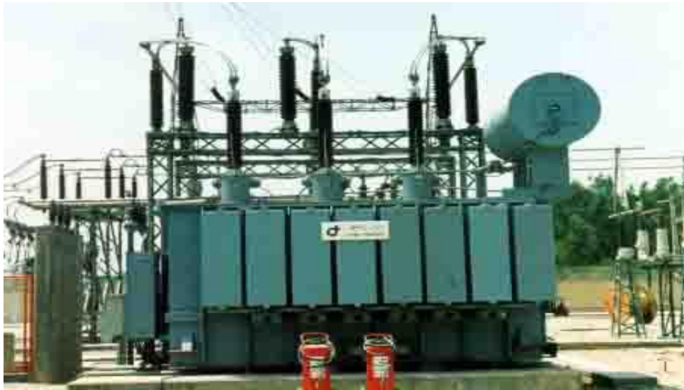
شکل یک ترانسفورماتور قدرت ساخت شرکت ایران ترانسفو
