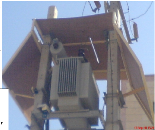
شکل ۱: نمای سایبان نصب شده بر روی ترانسفورماتور.
