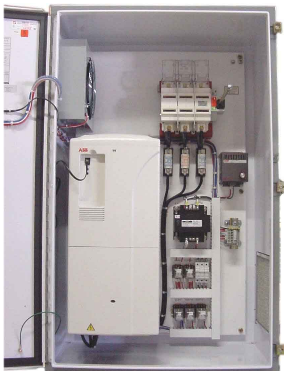
تابلوی کنترل موتور به کمک درایو
