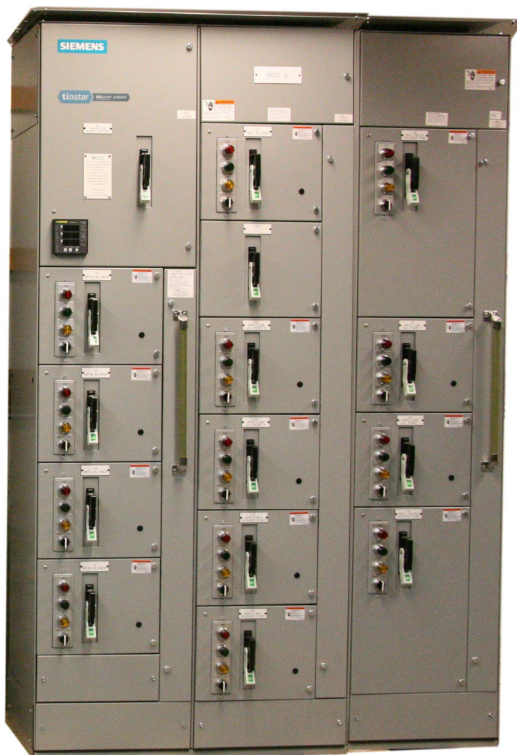
تابلوی کنترل موتوری MCC از نوع کشویی
