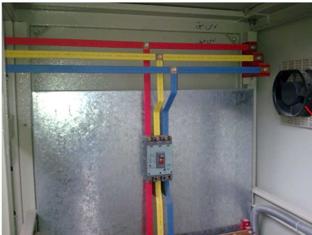
فن تهویه هوای تابلو
